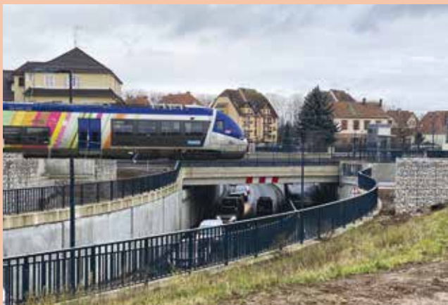
Les murs portants en gabion (cages remplies de pierres) sont des auto-drainants naturels. Ils ont d'ores et déjà été installés de part et d'autre du tunnel pour accueillir la future passerelle cyclable.
