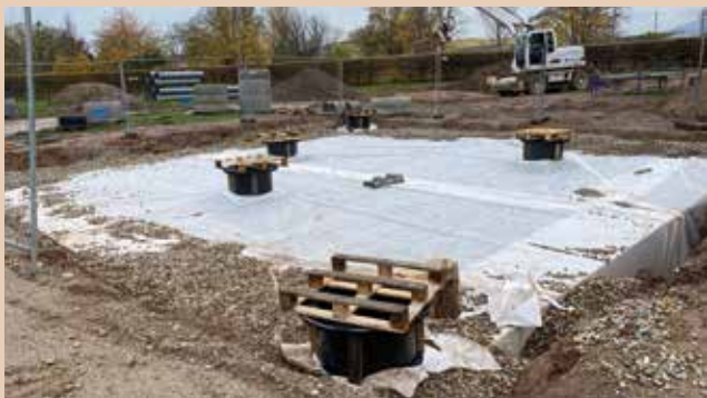
Un bassin d'infiltration de 154 m 3 a été aménagé près de l'aire de jeu, rue du Champ de feu. Une bâche géotextile a été mise en place sur des cagettes de rétention
