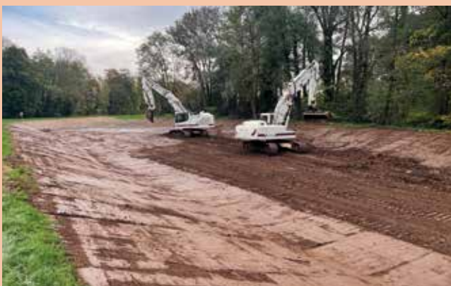
Sur le site de "Ochsenweid", ce sont les zones enherbées qui ont été décapées. Les travaux d'engazonnement se poursuivront au printemps 2023.
