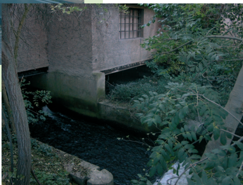
Ecluse et turbine de la Bischoffsmühle
