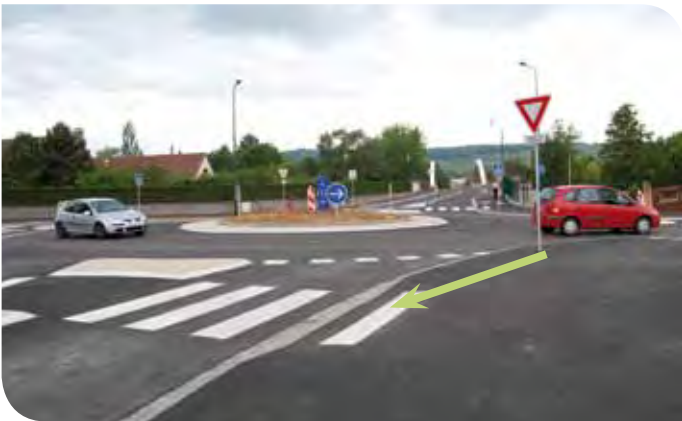
Les passages piétons ont été équipés de bandes podotactiles ou bandes d'éveil à la vigilance à destination des personnes mal voyantes.
