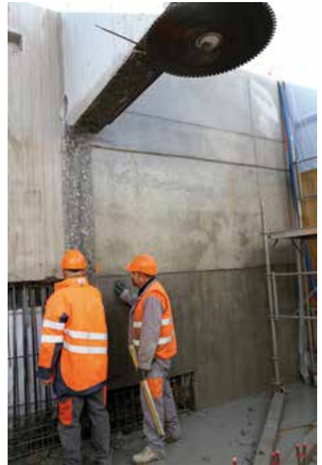
Pour assurer la liaison de la cage d'ascenseur de la voie A avec le souterrain existant, le maître d'ouvrage a fait appel à une entreprise spécialisée dans le sciage de béton pour découper le mur extérieur existant.
