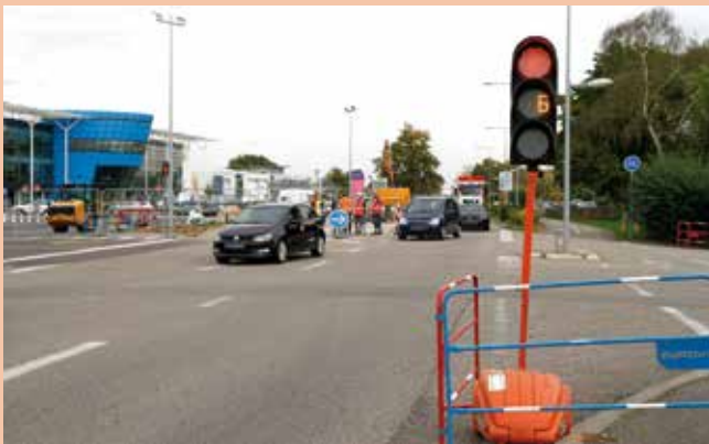
La Ville a privilégié une circulation gérée par un alternat de feux tricolores selon l'évolution du chantier.
