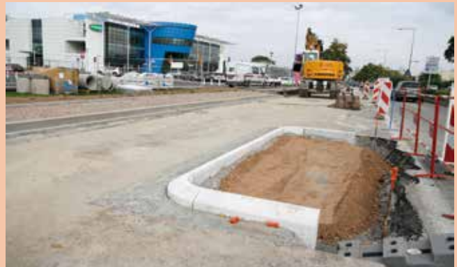
Les travaux consistent en une mise à niveau de la voirie avec notamment la création d'îlots.
