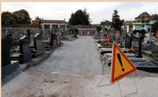
La première étape consiste à terrasser les allées puis à réaliser un coffrage pour délimiter la dalle et maintenir le béton jusqu'à sa prise.
